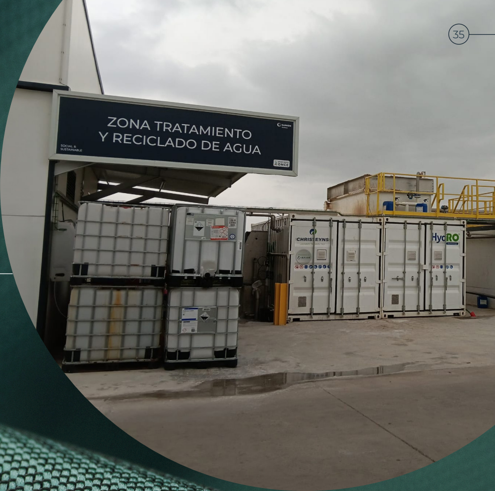
Planta de tratamiento y recuperación de agua de Sevilla Sur
