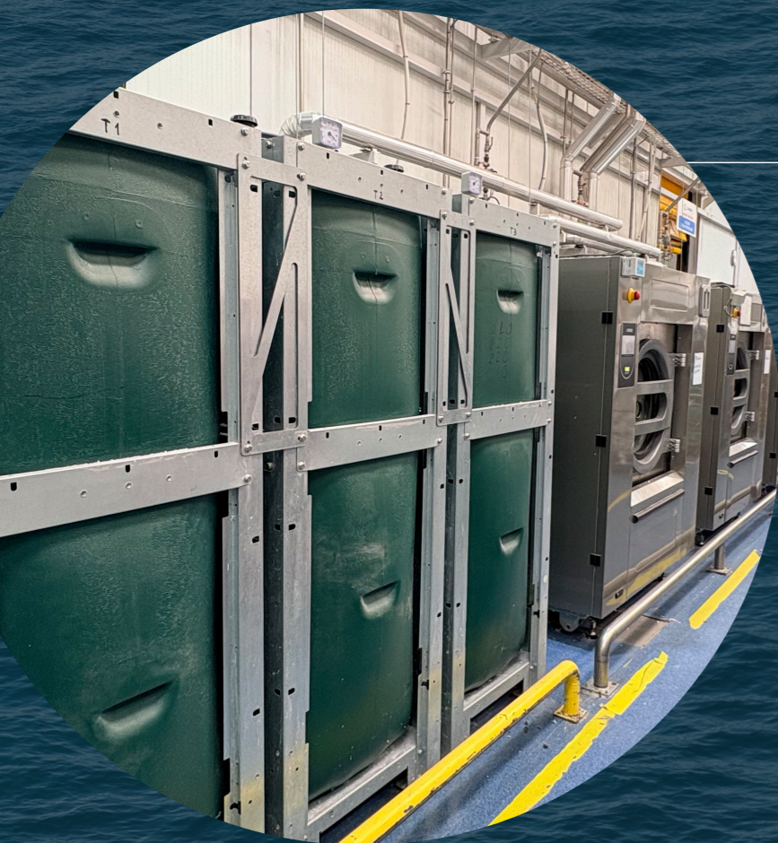
Recuperadores de lavadoras en la planta de Valladolid
